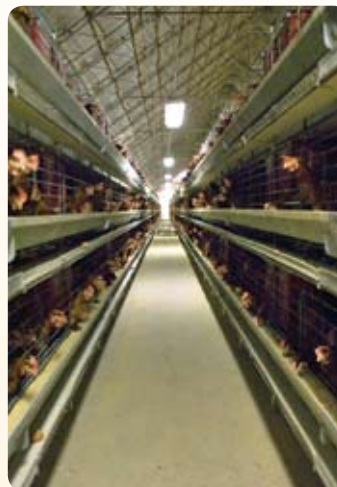
Régi elavult fénycsöves világítási rendszer tojókházban
